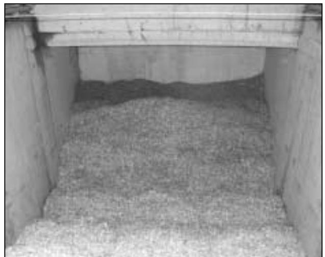
Silo à plaquette de la chaufferie de la piscine
